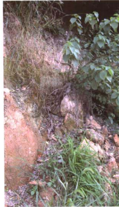
山体局部崩塌
