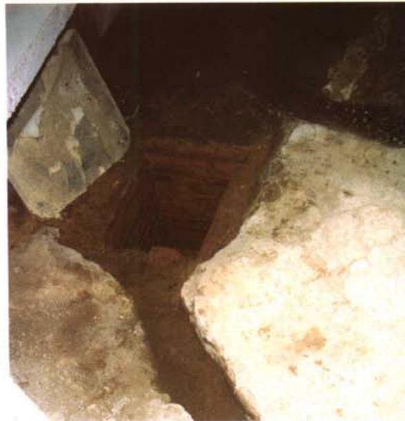
展示厅内临时积水
