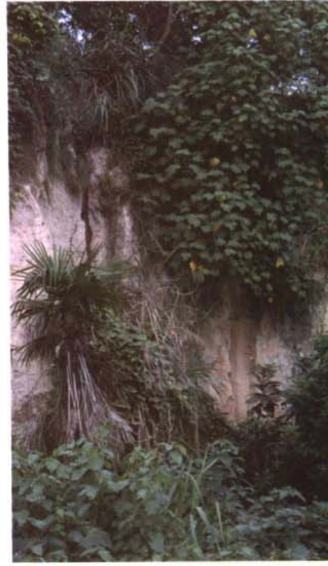
雨水冲刷，造成山体
