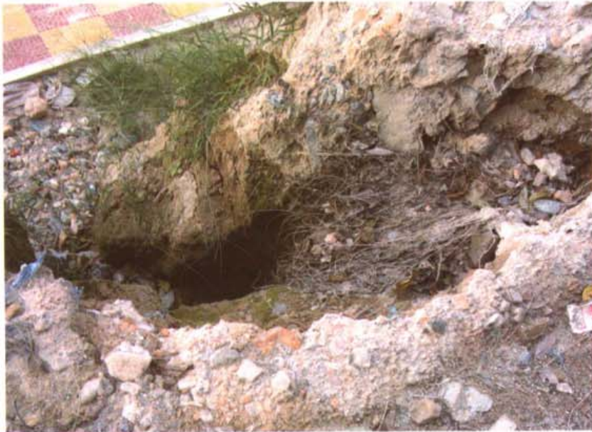
雨水冲刷，造成山体冲沟
