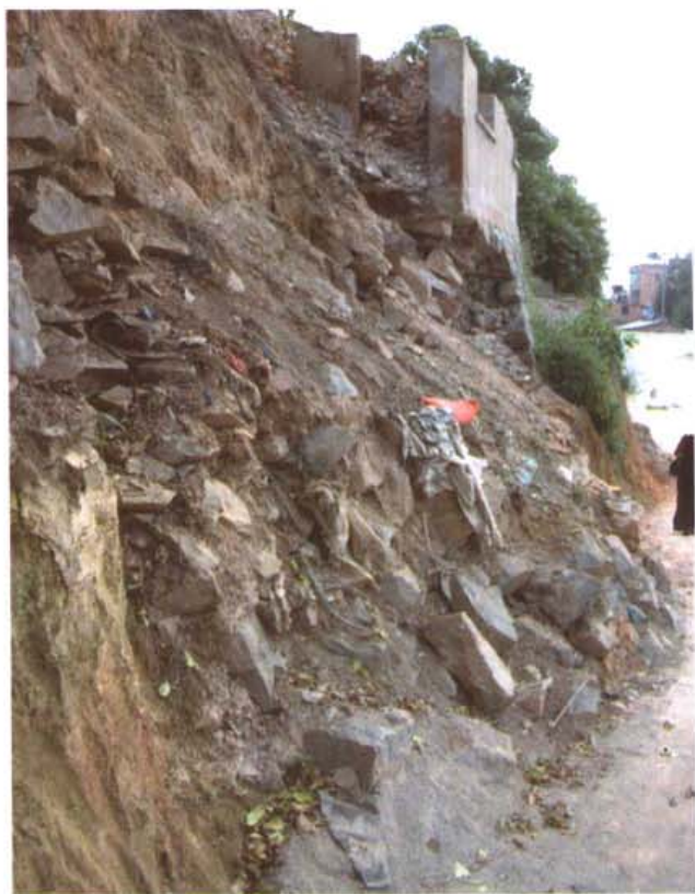
山体局部崩塌
