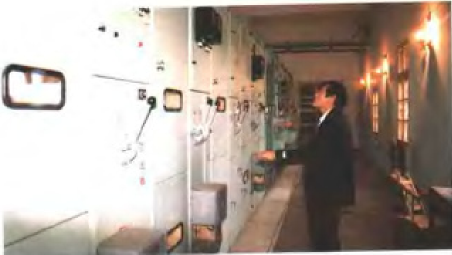
西埔变电站机房
