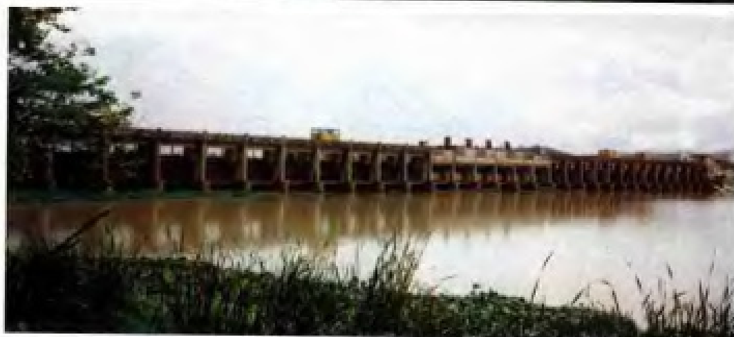
◀ 山美灌区洛阳桥闸
