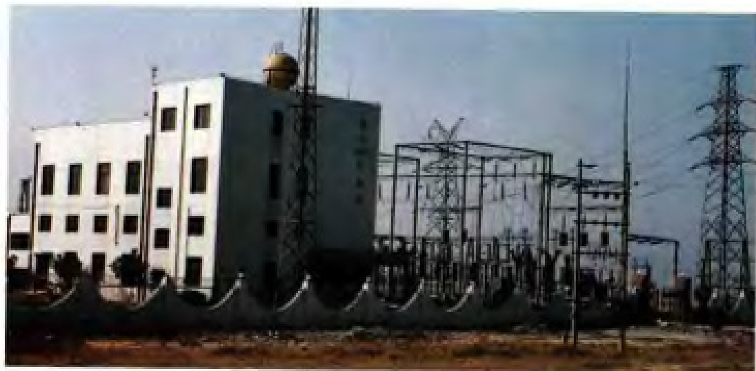
晋江内坑变电站 ▶
