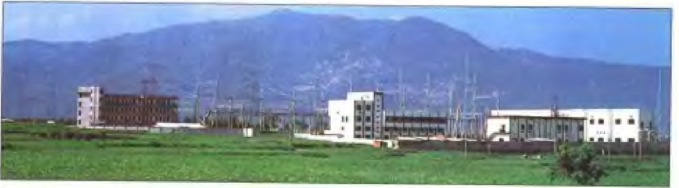
塘西 22 万伏变电站
