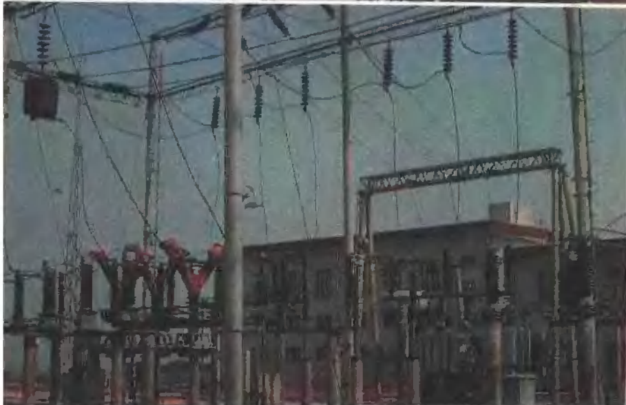
縣城萬伏變電站
