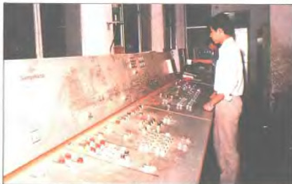
邵武刨花板厂控制室
