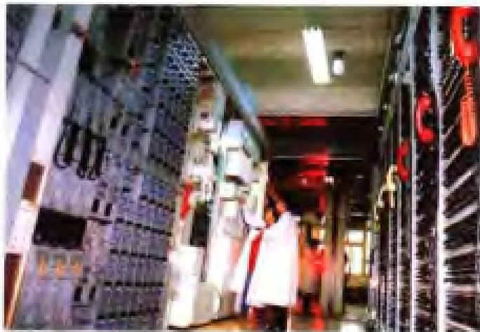
省电讯枢纽中心
