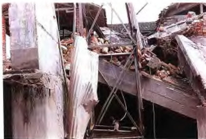
1997年5月13日，永安5.2级地震毁坏的漳平水泥厂厂房
