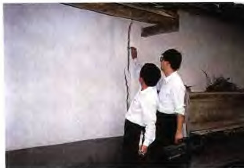
震后考察房屋墙体裂缝
