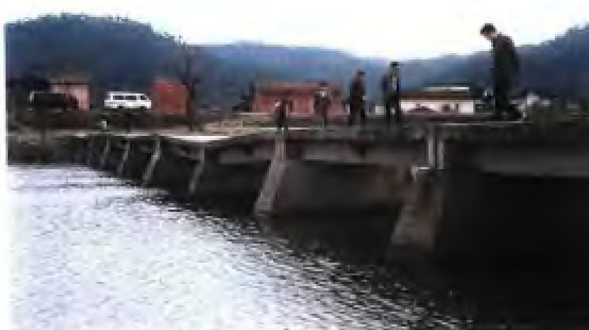
对被地震破坏的桥梁作震害评估
