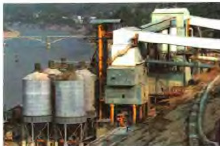
▲水口水电站二期混凝土拌和楼
