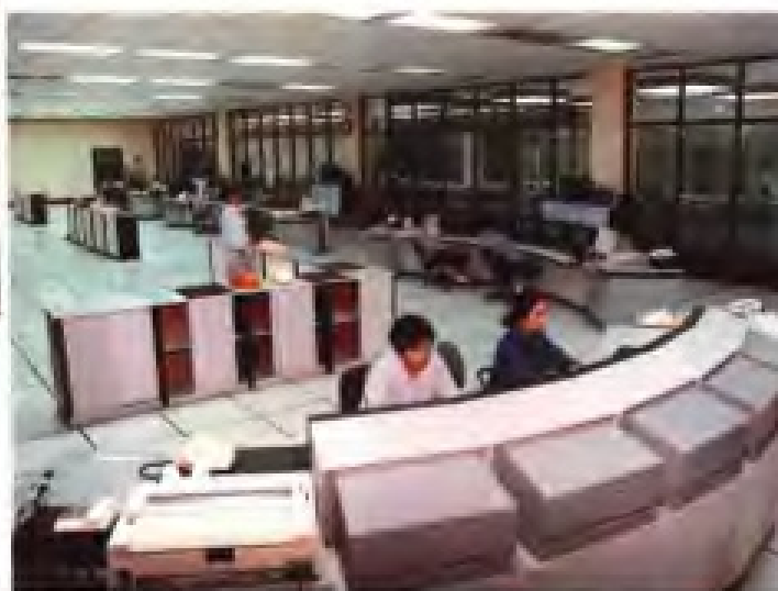
福建炼油厂生产装置中心控制室
