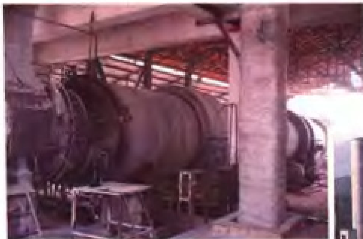
福州氮肥厂4万吨/年联碱蒸汽煅烧炉
