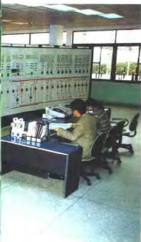
莆美135千伏变电站主控室
