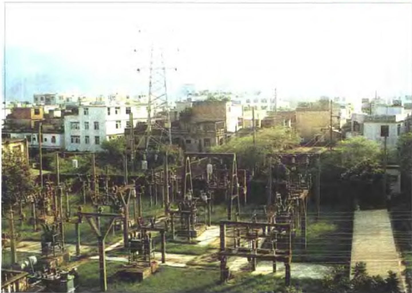
县电力公司供电网
